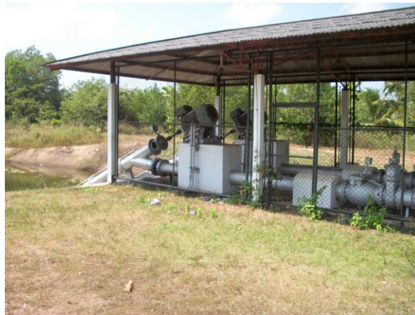
สถานีสูบน้ำด้วยไฟฟ้าขนาดใหญ่ บ้านกำแพง
